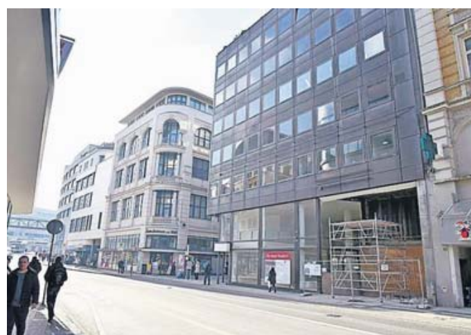
Unter anderem am Wall 28 laufen Arbeiten – einen Mieter für das Geschäftslokal gibt es aber noch nicht. Foto: Andreas Fischer
